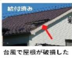
給付済み 台風で屋根が破損した
