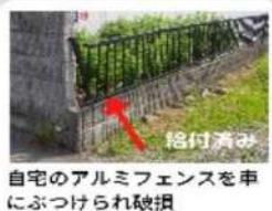
給付済み 自宅のアルミフェンスを車 にぶつけられ破損
