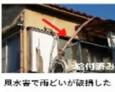
給付済み 風水害で雨どいが破損した
