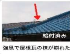
給付済み 強風で屋根瓦の棟が崩れた
