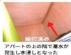
給付済み アパートの上の階で漏水が 発生し水浸しとなった
