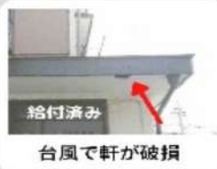
給付済み 台風で軒が破損
