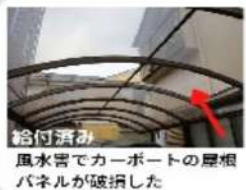
給付済み 風水害でカーポートの屋根 パネルが破損した
