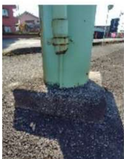
日光街道歩道橋柱の錆 (高萩北)
