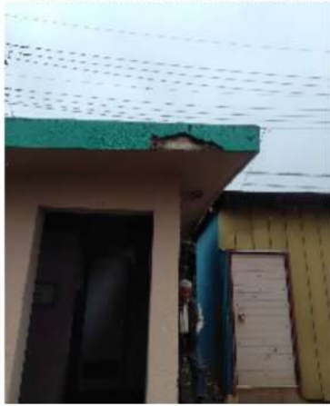
公園トイレのモルタル破損 (精明)
