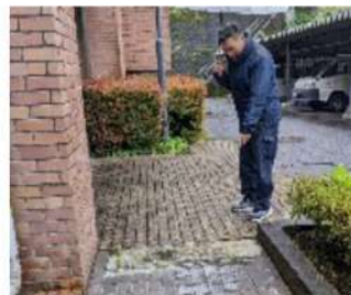
点字ブロックがはずされモルタルで補修 不十分な補修として再度報告
