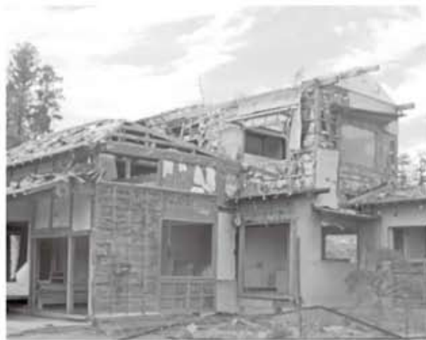
竜巻で屋根が飛ばされた家
